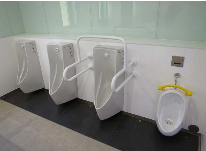
竹崎グランドトイレ 男性トイレ 小便器コーナー
