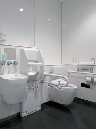
1号館 1F多機能トイレ
