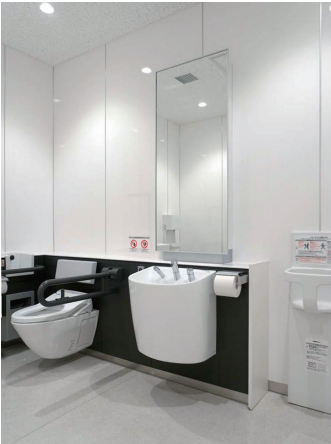
2号館 1F多機能トイレ
