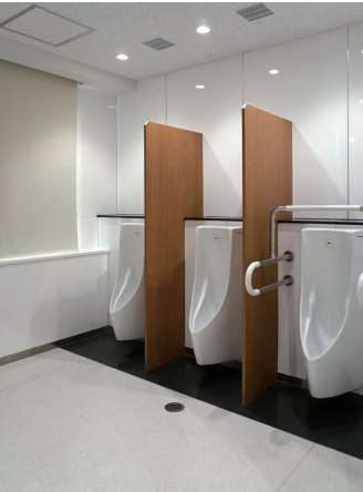
2号館 1F男性トイレ小便器コーナー
