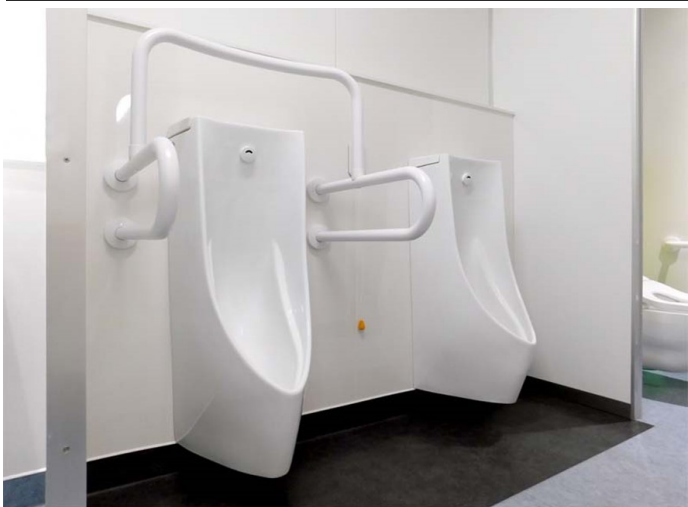
本館5F 男性トイレ 小便器コーナー
