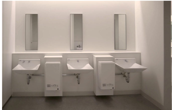
アリスタワー 6F女性トイレ 洗面コーナー
