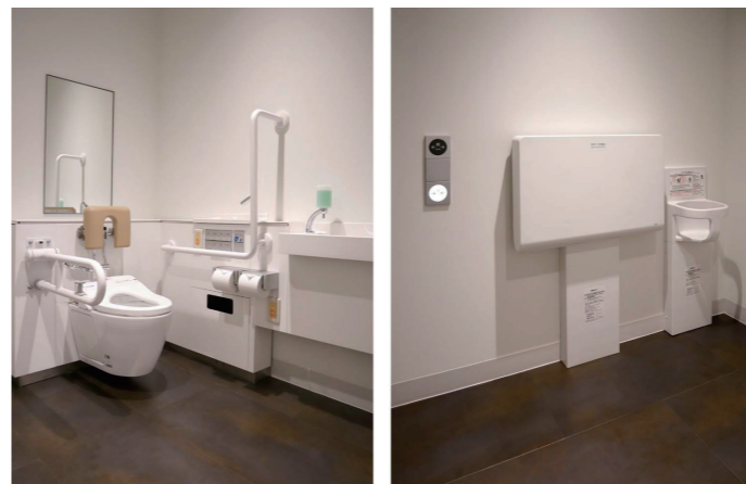
ハブキューブ 1F多機能トイレ
