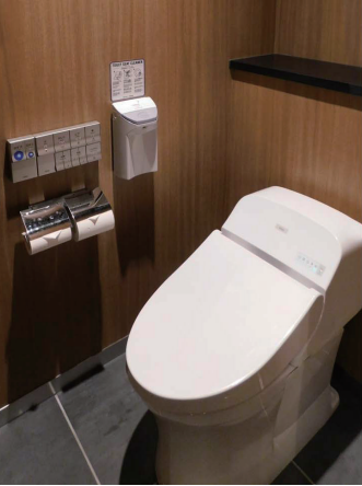
レストラン棟トイレ 大便器ブース・ 小便器コーナー
