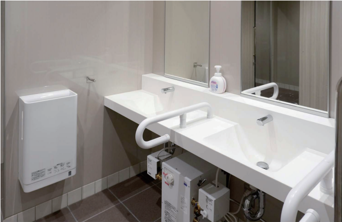
女性トイレ 洗面コーナー
