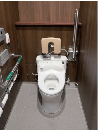
男性トイレ 大便器ブース
