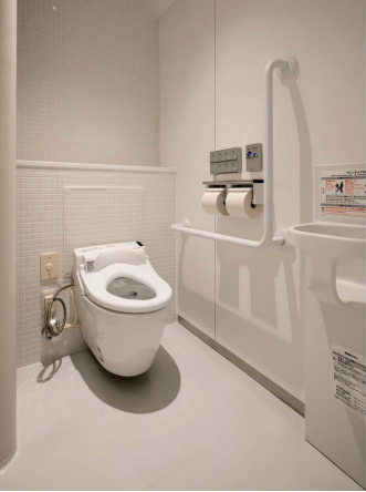
男性トイレ 大便器ブース
