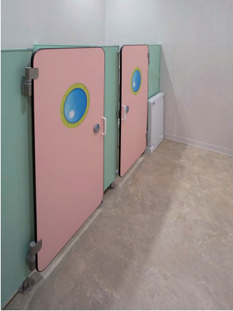
キッズトイレ 大便器ブース
