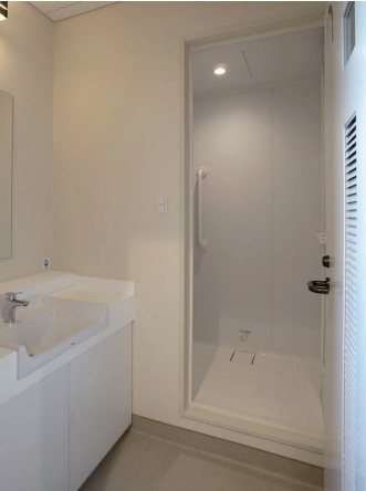
2F 当直室 シャワールーム
