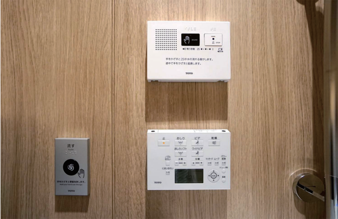
男性トイレ 非接触ブース
