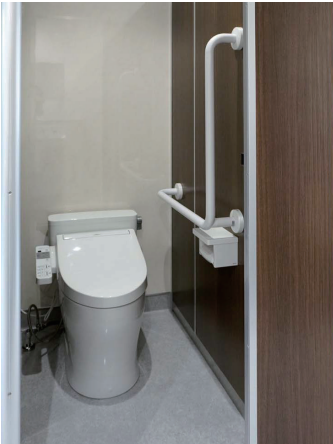
職員トイレ 大便器コーナー
