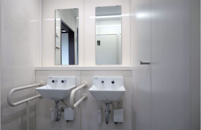
女性トイレ 洗面コーナー
