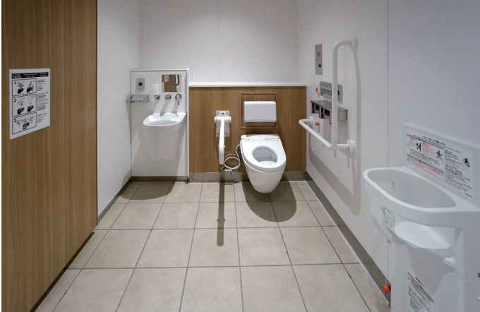
女性トイレ 簡易多機能ブース
