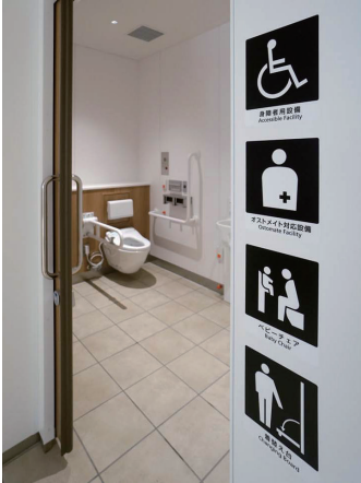
女性トイレ 簡易多機能ブース
