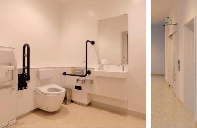
2F 多目的トイレ
