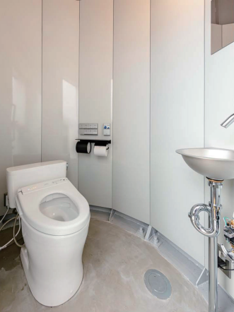
女性トイレ 大便器ブース
